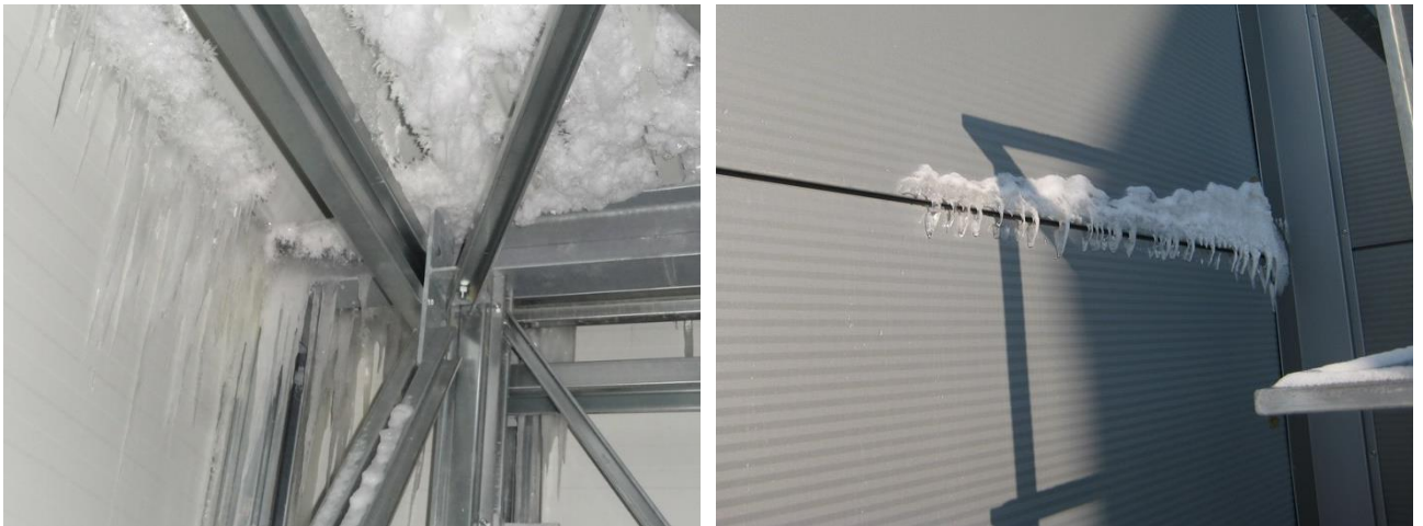
Abbildung 1: Eisbildung aufgrund mangelhafter Luftdichtheit (Dachrand / Paneelstoss)
